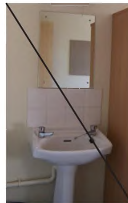
Плохо Раковина с пьедесталом. Фартук из плитки
